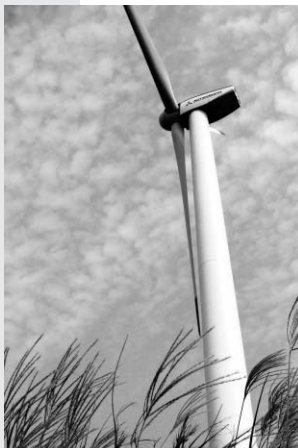
鹿町ウインドファームの風車。高台に15基の風車が回り、8,000世帯分の電力を発電している。
